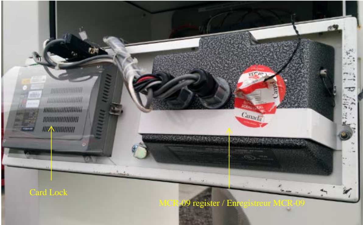
Figure 3: Card lock and register connection and temperature probe sealing / Scellage de la connexion entre le card lock et le registre, et de la sonde de température
