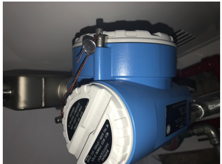
Figure 2: Endress and Hauser 8FE15 meter sealing / Scellage du compteur Endress and Hauser 8FE15
