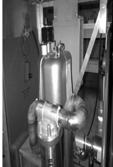
Heating system/ Système chauffage
