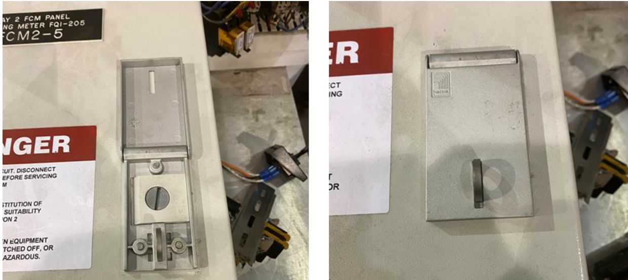
Figure 12: Left: Typical FCM Enclosure with Seal Broken and Latch Open; Right: Typical FCM Enclosure with Seal Broken | Gauche : boîtier FCM typique avec joint brisé et loquet ouvert ; Droite : Boîtier FCM typique avec joint brisé.
