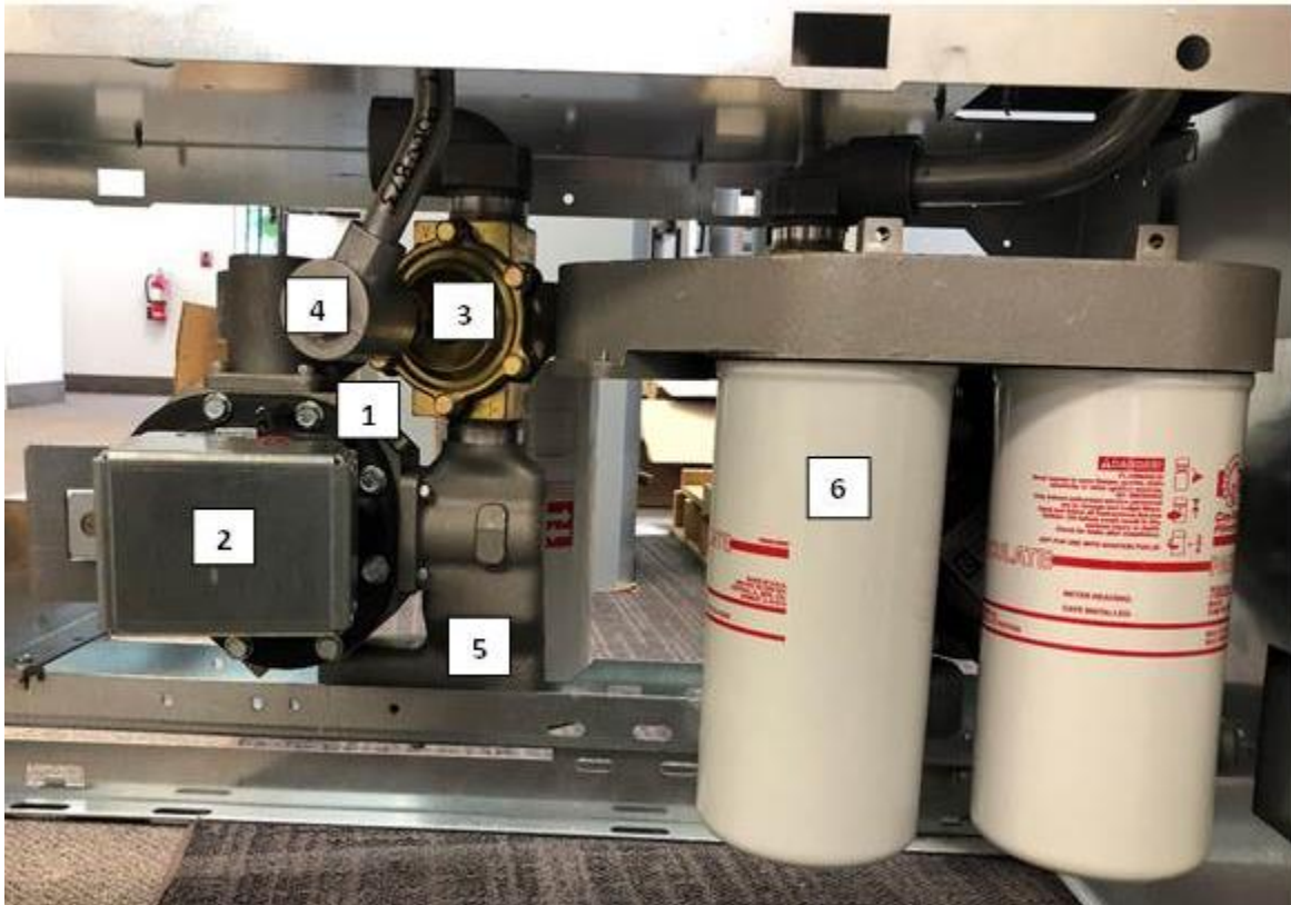
Fig. 3b Hydraulic structure of High Speed dispensers | Installation hydraulique des distributeurs à capacité élevée
