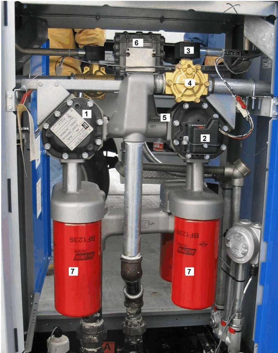
Fig. 7: Hydraulic structure of UHC dispensers / Installation hydraulique des distributeurs CUE
