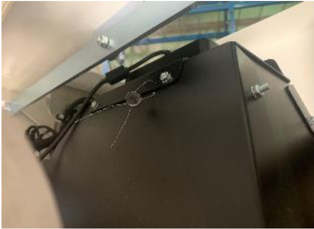
Typical camera sealing (P2 Kiosk) / Scellage typique d'une caméra (P2 Kiosk)
