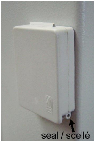
Typical control cabinet sealing / Scellage typique du boîtier de l'unité de commande
