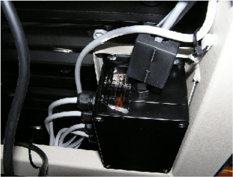
Sealing of Junction Box with Paper Seal / Scellage de la boîte de jonction avec scellé en papier
