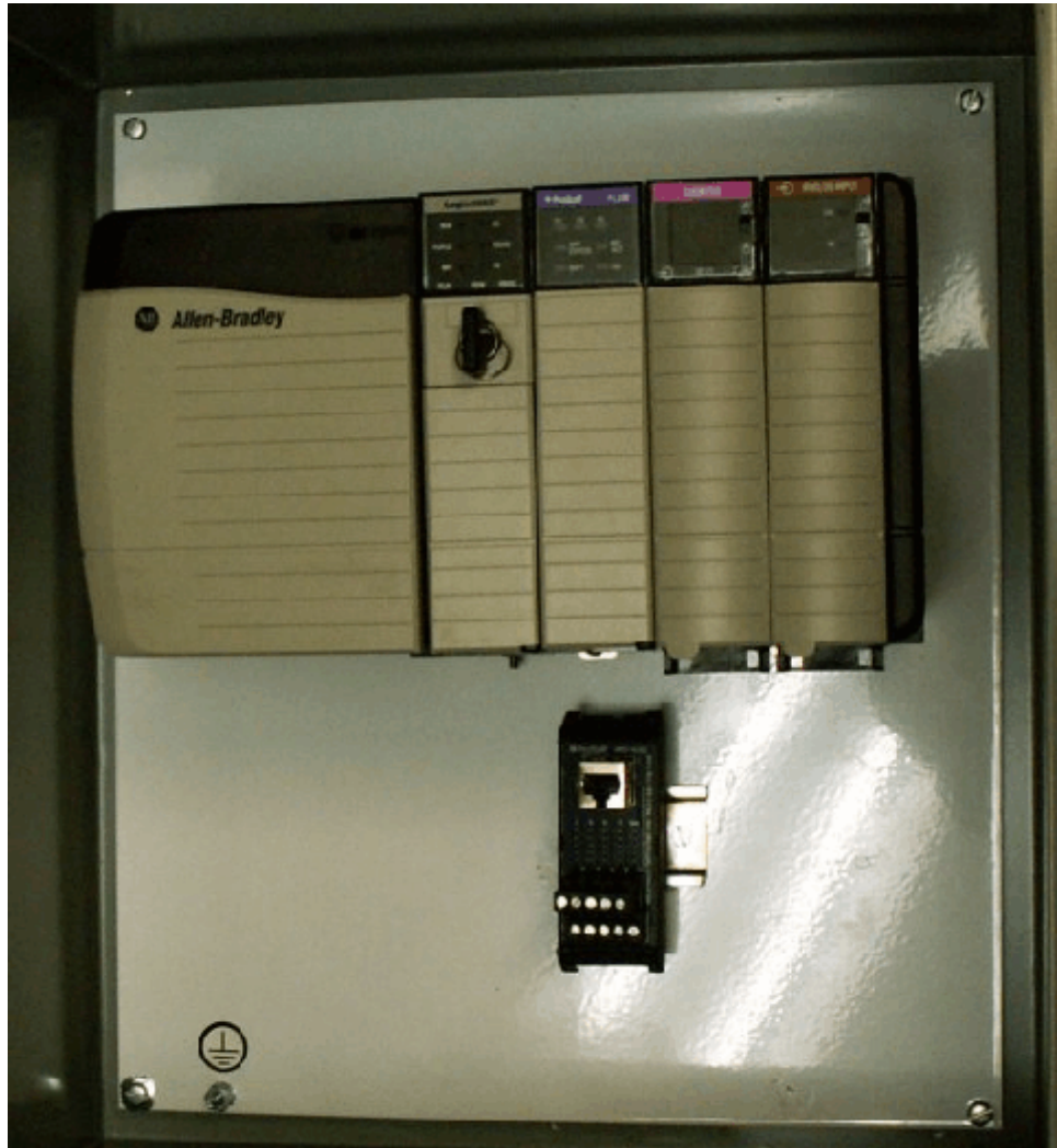
Figure 3 MVI56-AFC Interior View / Vue intérieure du MVI56-AFC
