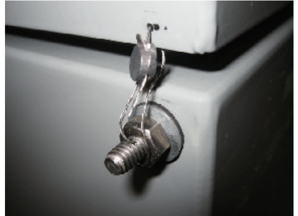
Figure 10 Sealing provisions for steel enclosure / dispositifs de scellage pour le boîtier en acier
