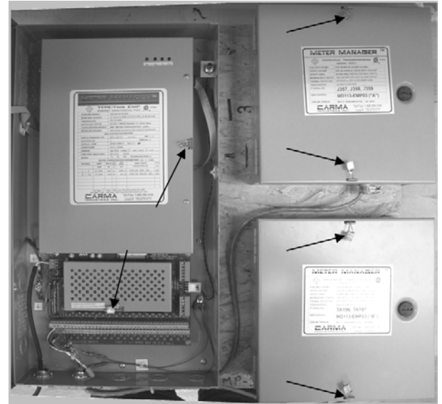
A Model T2mA meter with two PT enclosures that has six metrological seals / Un compteur Modèle T2mA avec deux boîtiers de transformateurs de tension et six sceaux métrologiques.
