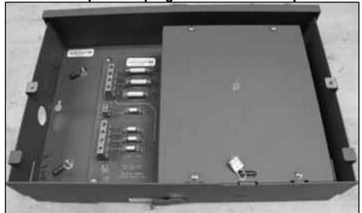
Voltage Transformer Metrological Sealing Location / Emplacement du sceau métrologique du transformateur de tension
