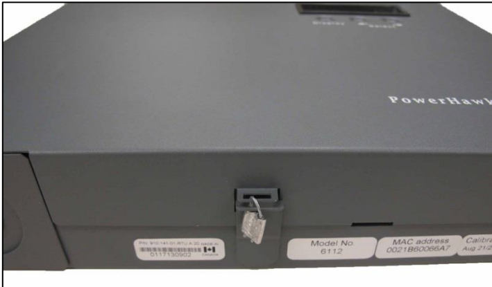
Installation Sealing Location / Emplacement du sceau d'installation
