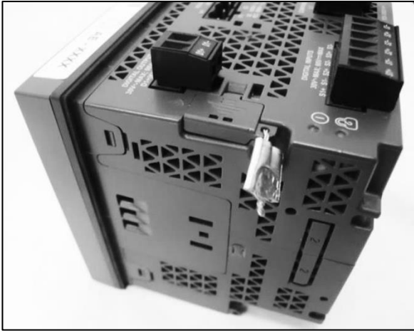
Sealed meter / Compteur scellé
