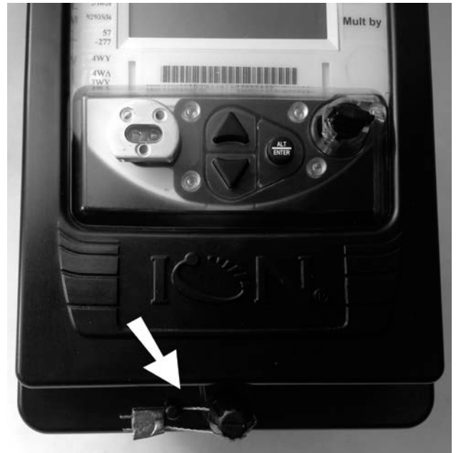
Single seal on a switchboard meter / Sceau unique sur un compteur pour tableau de distribution.
