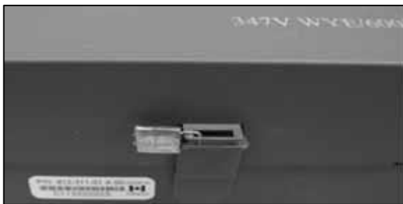
Voltage Transformer Installation Sealing Location / Emplacement du sceau d'utilité du transformateur de tension
