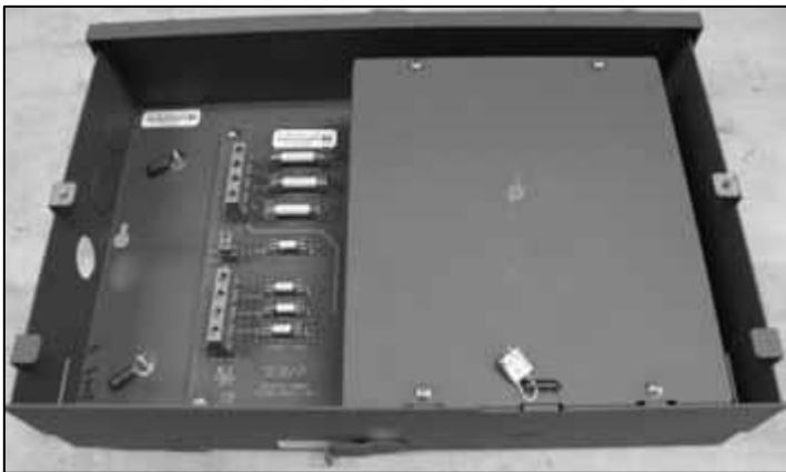
Voltage Transformer Metrological Sealing Location / Emplacement du sceau métrologique du transformateur de tension
