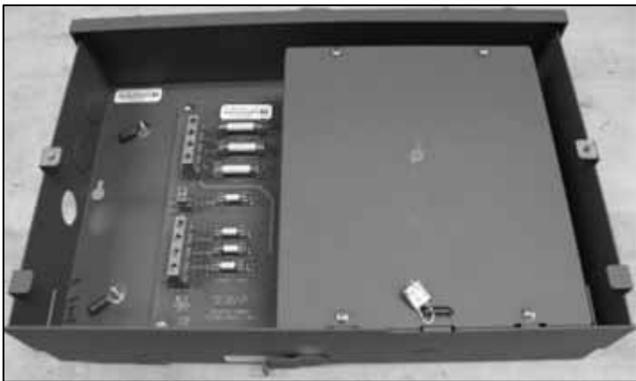
Voltage Transformer Metrological Sealing Location / Emplacement du sceau métrologique du transformateur de tension
