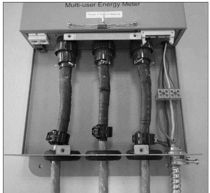
Connections outside of the metrology compartment of PS2007-24A and MR1-120MA-24 / Connexions à l'extérieur du compartiment de métrologie pour PS2007-24A et MR1-120MA-24
