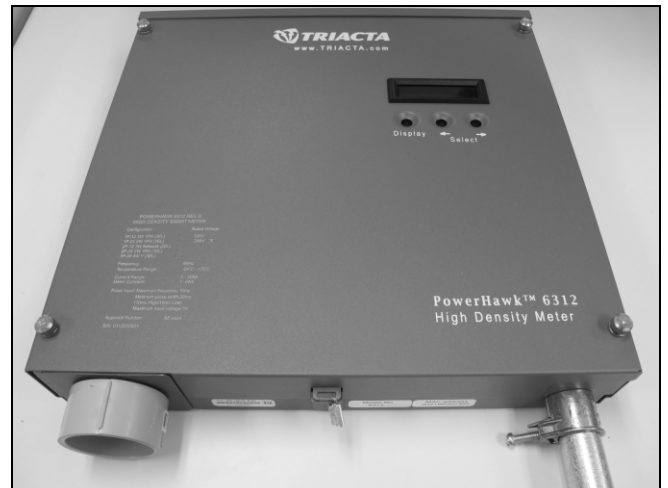
(2) Installation Sealing Location / (2) Emplacement du sceau d'installation
