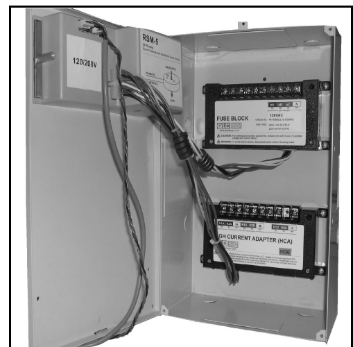
Inside the metallic enclosure / Intérieur de l'enceinte métallique
