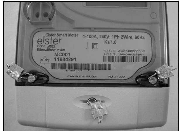
Sealing of the gREX meter / Scellage du compteur gREX
