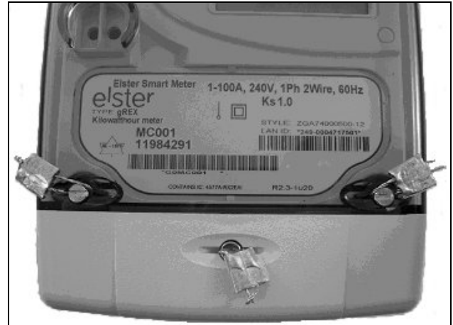
Sealing of the gREX meter / Scellage du compteur gREX
