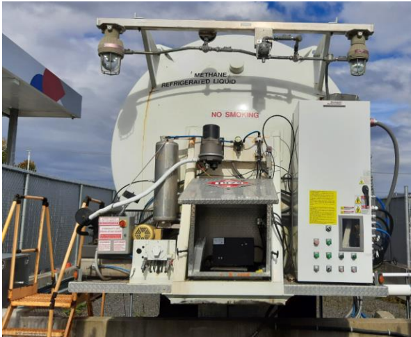
Figure 4 PLC panel and LNG storage system | Panneau de PLC et système de stockage de GNL
