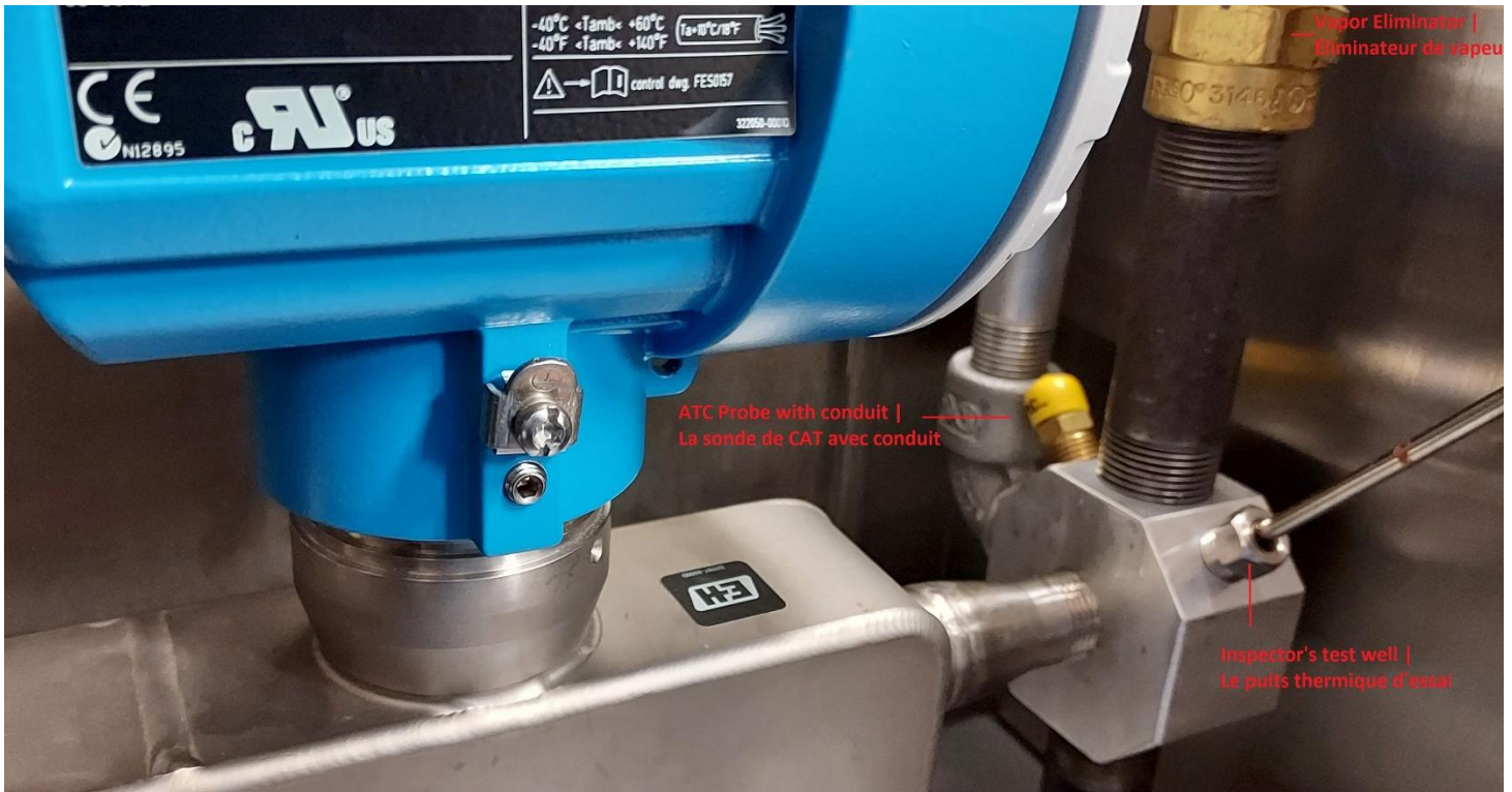
Figure 8: Cabinet piping when using the LPGmass 8FE15 meter | Tuyauterie du cabinet lors de l'utilisation du compteur LPGmass 8FE15
