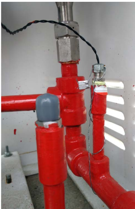
Figure 5: Temperature probe and thermal well sealing | Scellage de la sonde de température et du puits thermique
