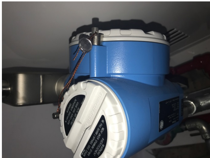
Figure 2: Endress and Hauser 8FE15 meter sealing / Scellage du compteur Endress and Hauser 8FE15
