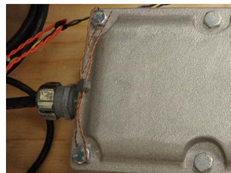
Fig. 2: Intrinsically Safe Power Control Module sealing / Le scellage du module de contrôle d'alimentation à sécurité intrinsèque (MCA)
