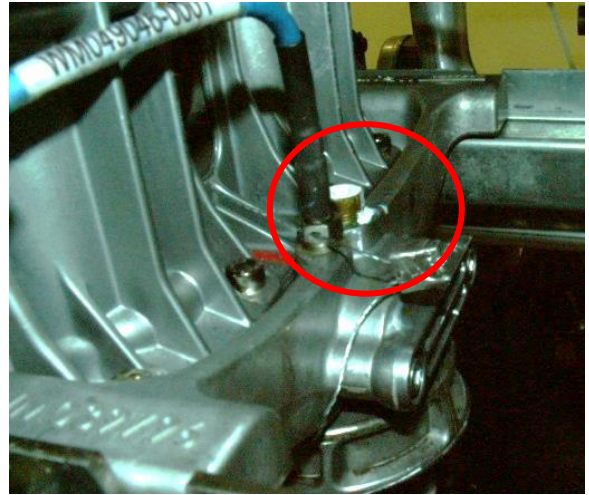
Figure 10 Side of Xflo meter with the ATC temperature probe and thermal well | Vue latérale du Xflo avec la sonde du CAT et le puit thermométrique
