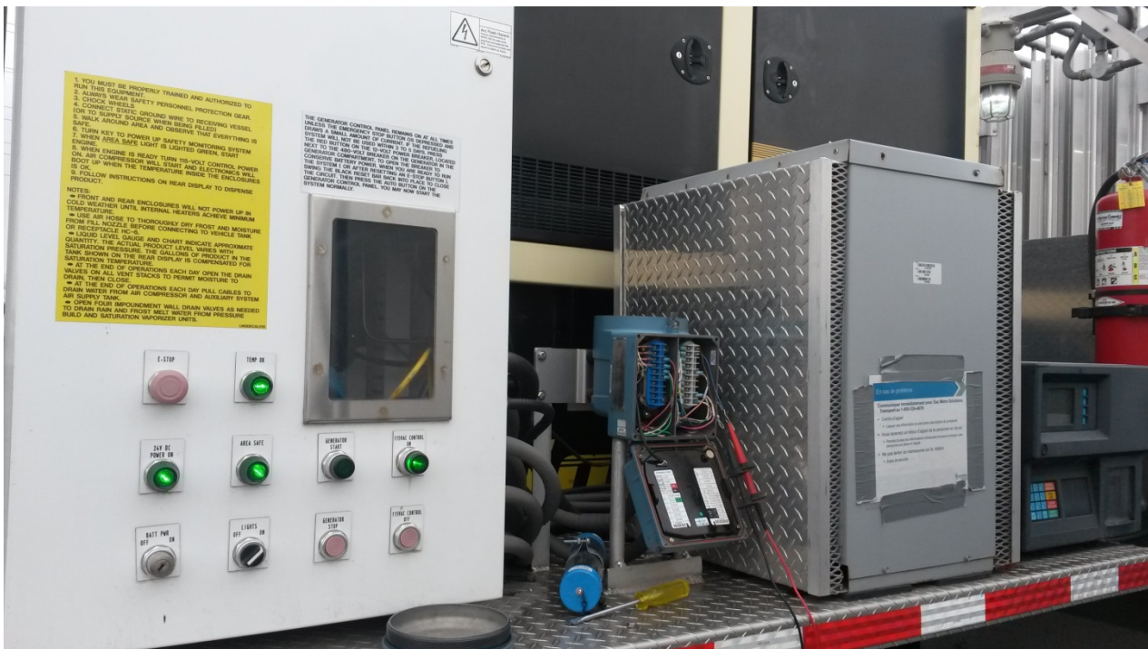
Figure 6: LNG mobile filling station, CardLock Reader, MDV 3700 transmitter and FSC3000 Controller / Station mobile de remplissage GNL, lecteur de cartes, transmetteur MDV 3700 et contrôleur FSC3000
