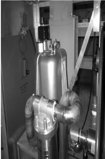
Heating system/ Système chauffage
