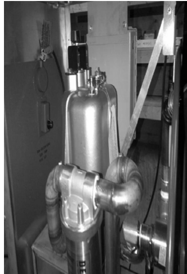
Heating system/ Système chauffage
