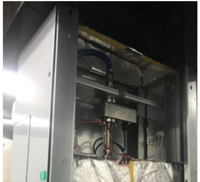
Figure 5 Electromagnetic DEF flowmeter inside the insulated side cabinet | Débitmètre électromagnétique de FED à l'intérieur du boîtier latéral isolé.
