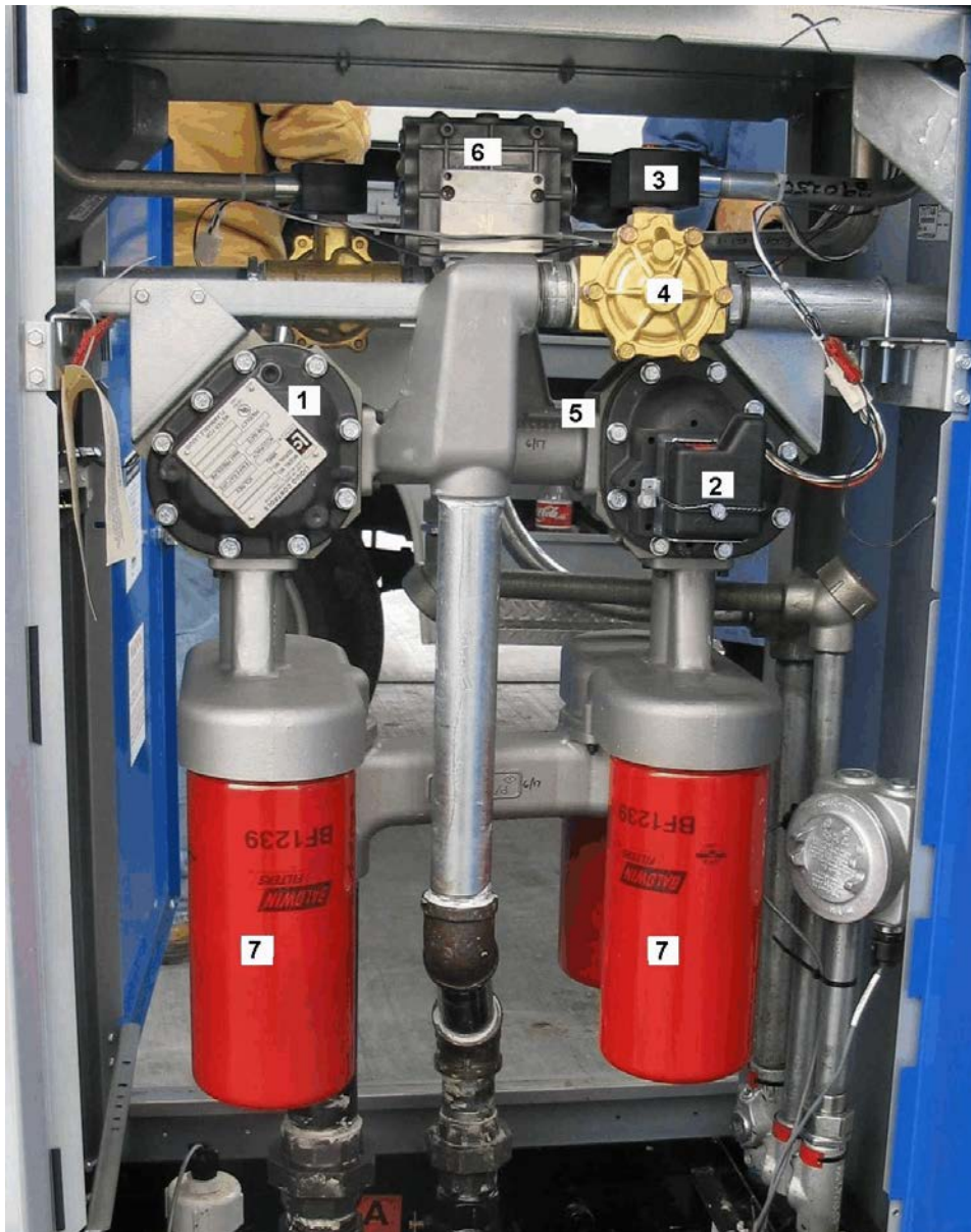
Fig. 9: Hydraulic structure of UHC dispensers / Installations hydrauliques des distributeurs CUE
