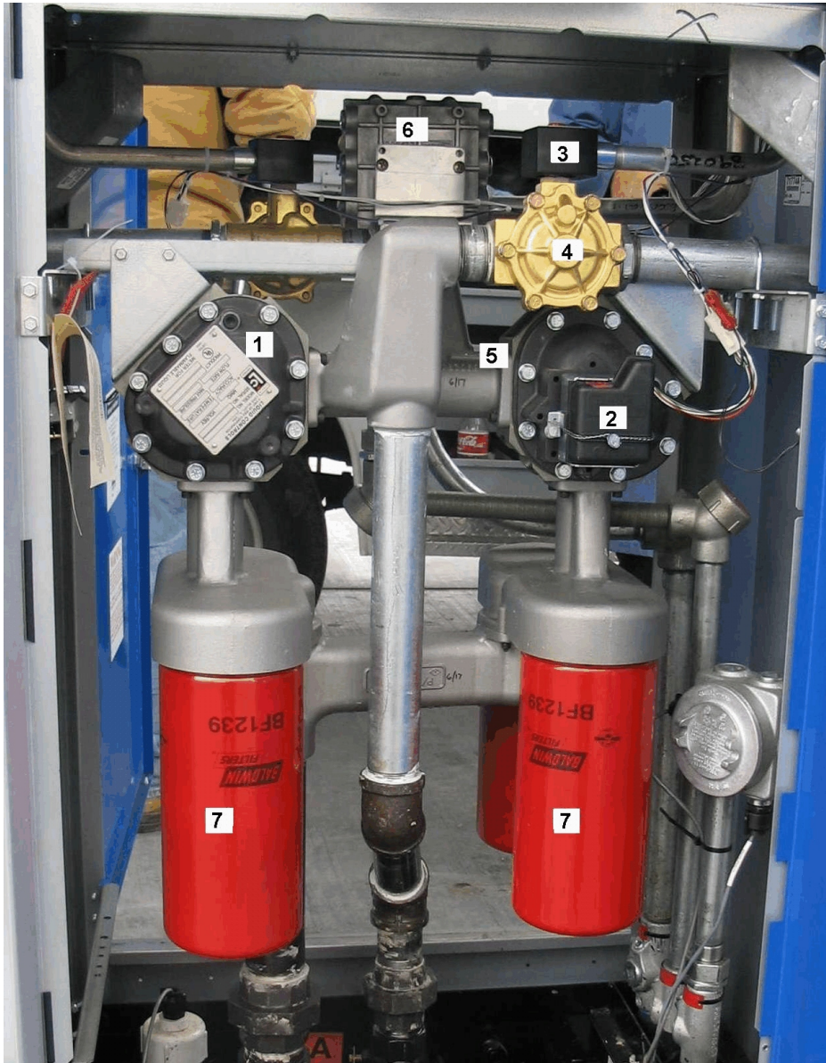
Fig. 7: Hydraulic structure of UHC dispensers / Installations hydrauliques des distributeurs CUE
