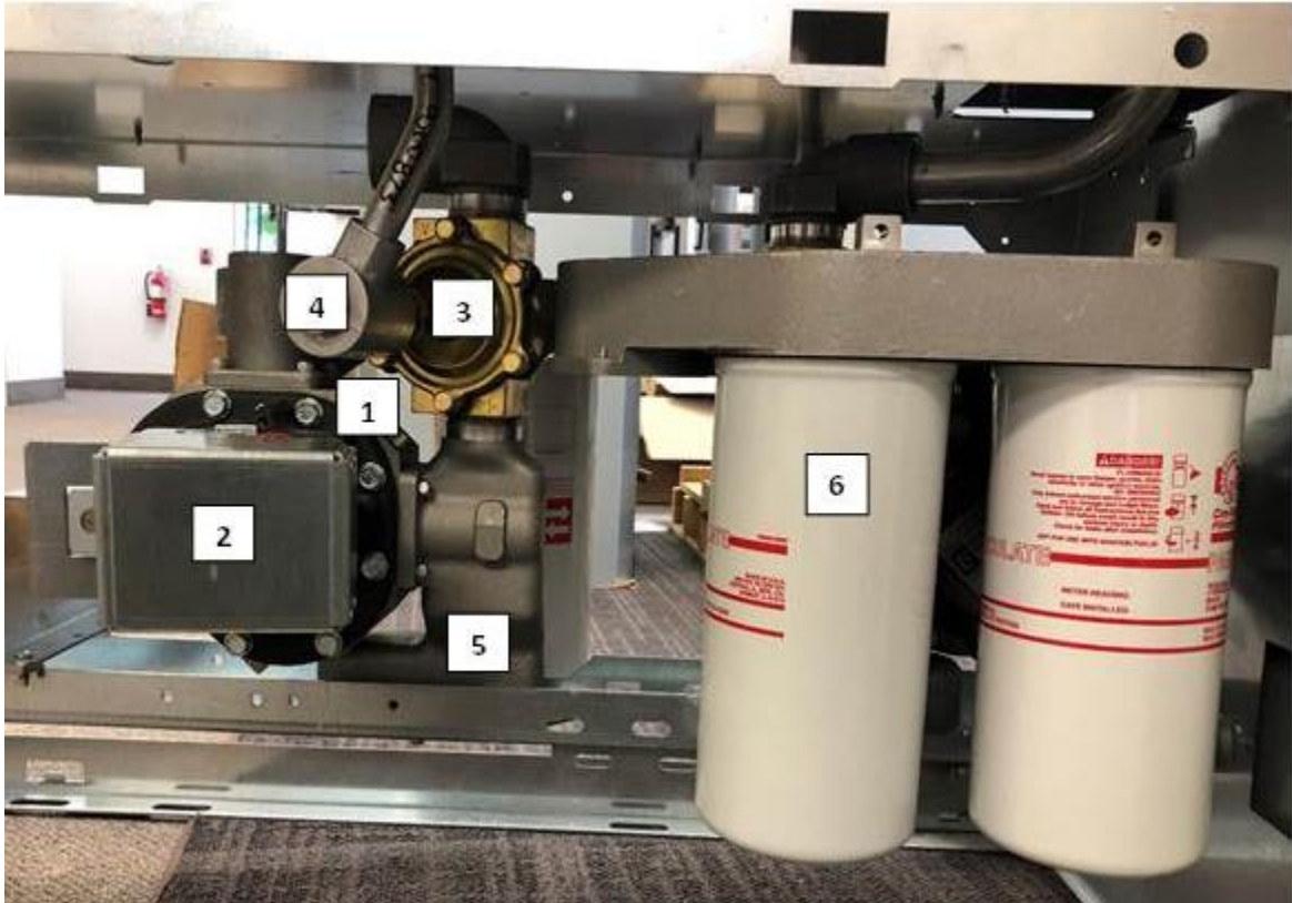
Fig. 3b Hydraulic structure of High Speed dispensers | Installation hydraulique des distributeurs à capacité élevée
