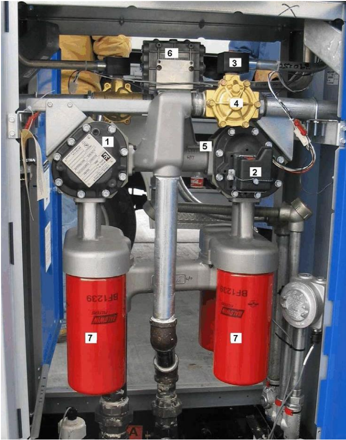
Figure 3a: Hydraulic structure of High Speed dispensers | Installation hydraulique des distributeurs à capacité élevée
