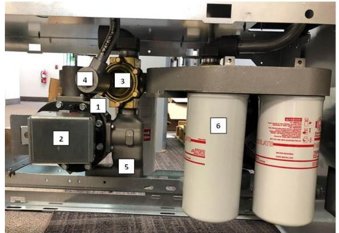
Figure 3b: Hydraulic structure of High Speed dispensers | Installation hydraulique des distributeurs à capacité élevée
