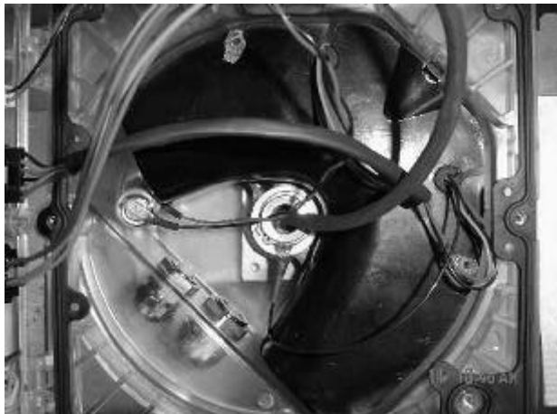
Figure 2: ground wire attached to center of housing/fil de masse fixé au centre du boîtier
