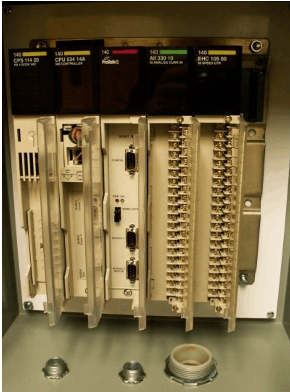
Figure 3 PTQ-AFC Interior View / Vue intérieure du PTQ-AFC
