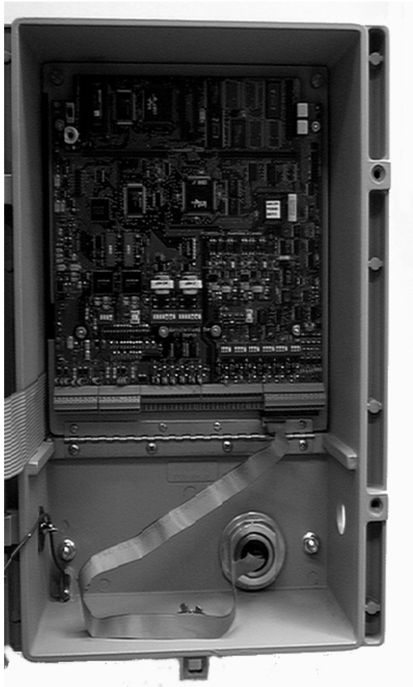
Figure 7 : Internal view of enclosure including I/O board and connections / Vue intérieure du boîtier, avec les connections et entrées/sorties.
