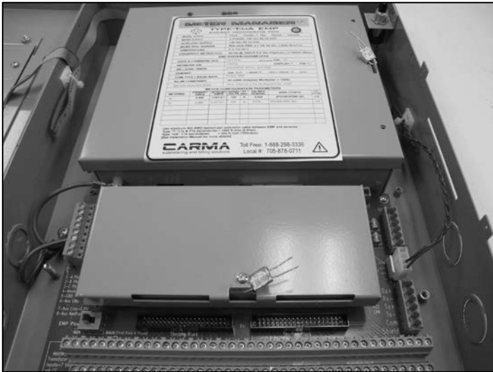
Meter Sealing / Scellage du compteur
