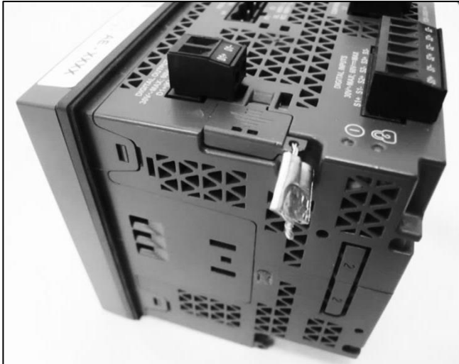
Sealed meter / Compteur scellé
