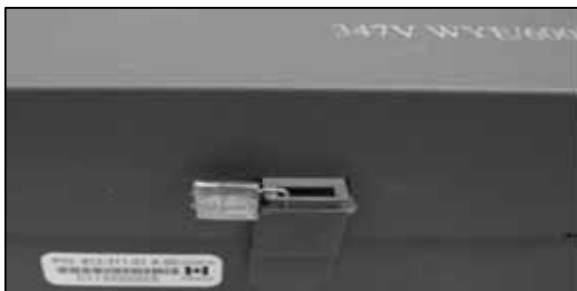
Voltage Transformer Installation Sealing Location / Emplacement du sceau d'utilité du transformateur de tension
