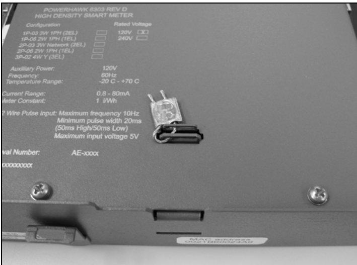
Meter Sealing / Scellage du compteur
