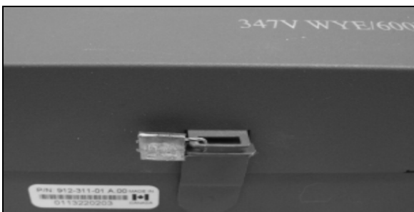
Voltage Transformer Installation Sealing Location / Emplacement du sceau d'utilité du transformateur de tension
