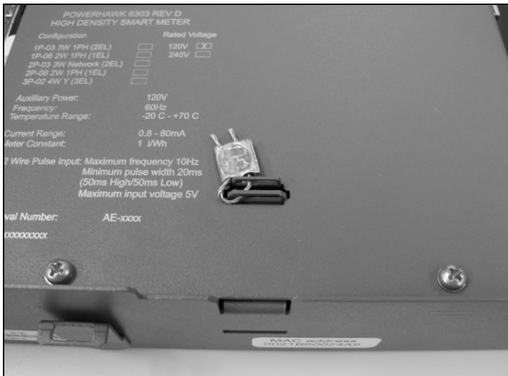
Meter Sealing / Scellage du compteur
