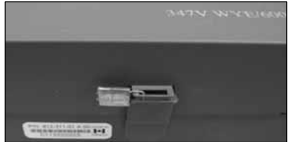
Voltage Transformer Utility Sealing Location / Emplacement du sceau d'utilité du transformateur de tension
