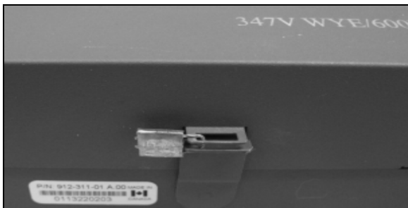
Voltage Transformer Utility Sealing Location / Emplacement du sceau d'utilité du transformateur de tension
