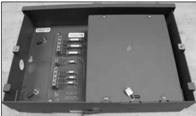
Voltage Transformer Metrological Sealing Location / Emplacement du sceau métrologique du transformateur de tension
