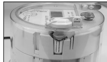
Battery Hatch / La trappe de la pile
